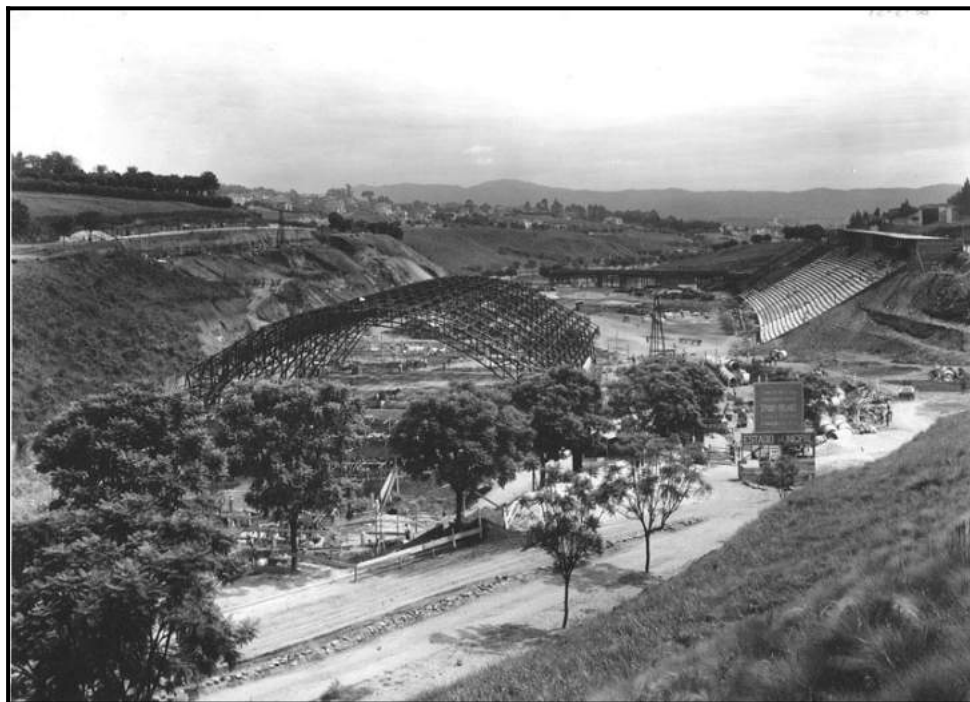
Foto panorâmica mostrando o avanço das obras do estádio, identificando-se a estrutura da cobertura do ginásio e a arquibancada lateral direita já assentada sobre o talude da gruta. Ao fundo, a Serra da Cantareira.
